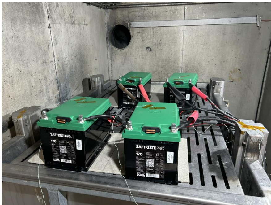
Bild 17: Lithium-Ionen-Batterie Typ Saftkiste PRO170 im Kurzschlussprüfstand
